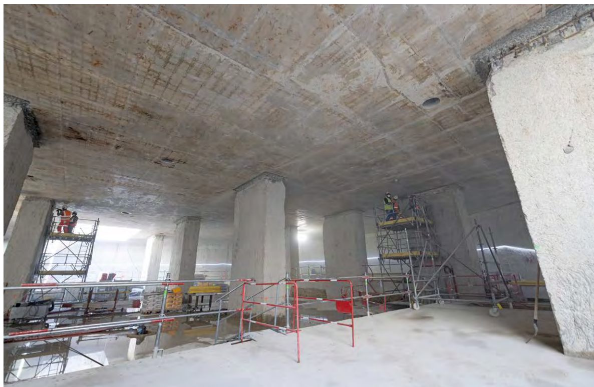
Blick in das Überlaufbecken mit einer Speicherkapazität von 50.000 m 3 .
