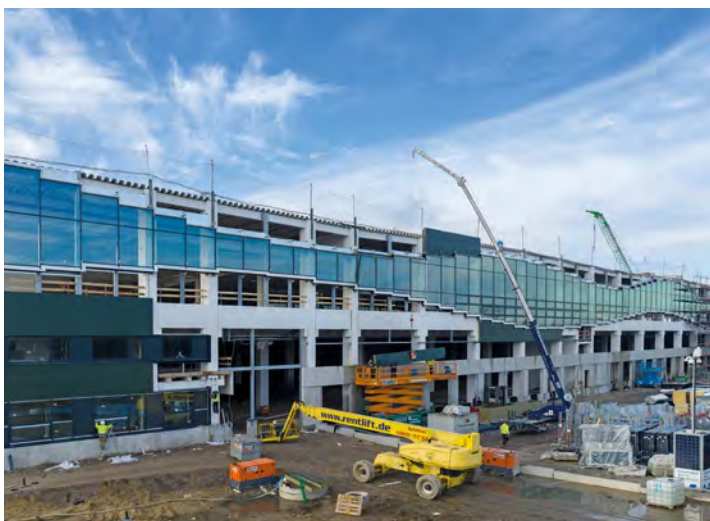
Die Montage der charakteristischen Facid Wave: Auf einer Länge von 270 m ist jede Stütze ein Unikat.
